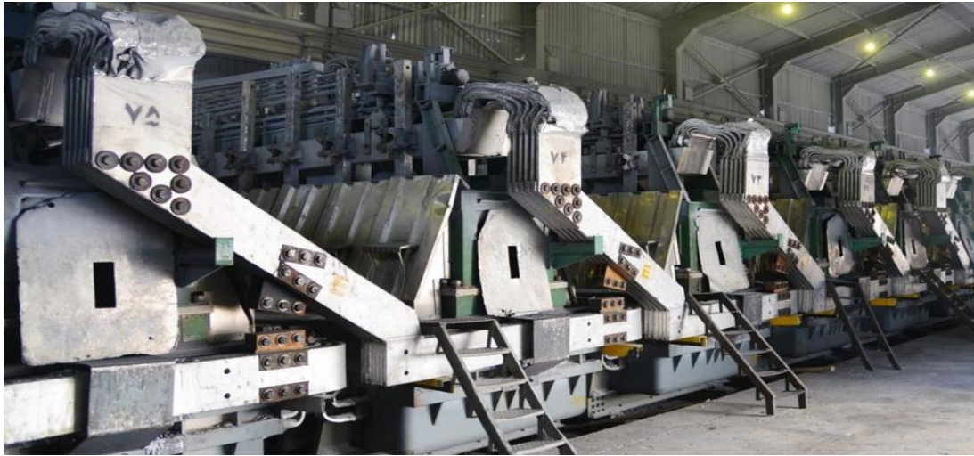
کارگاه احیاء یک ( ۷۰ کیلو آمپر)
